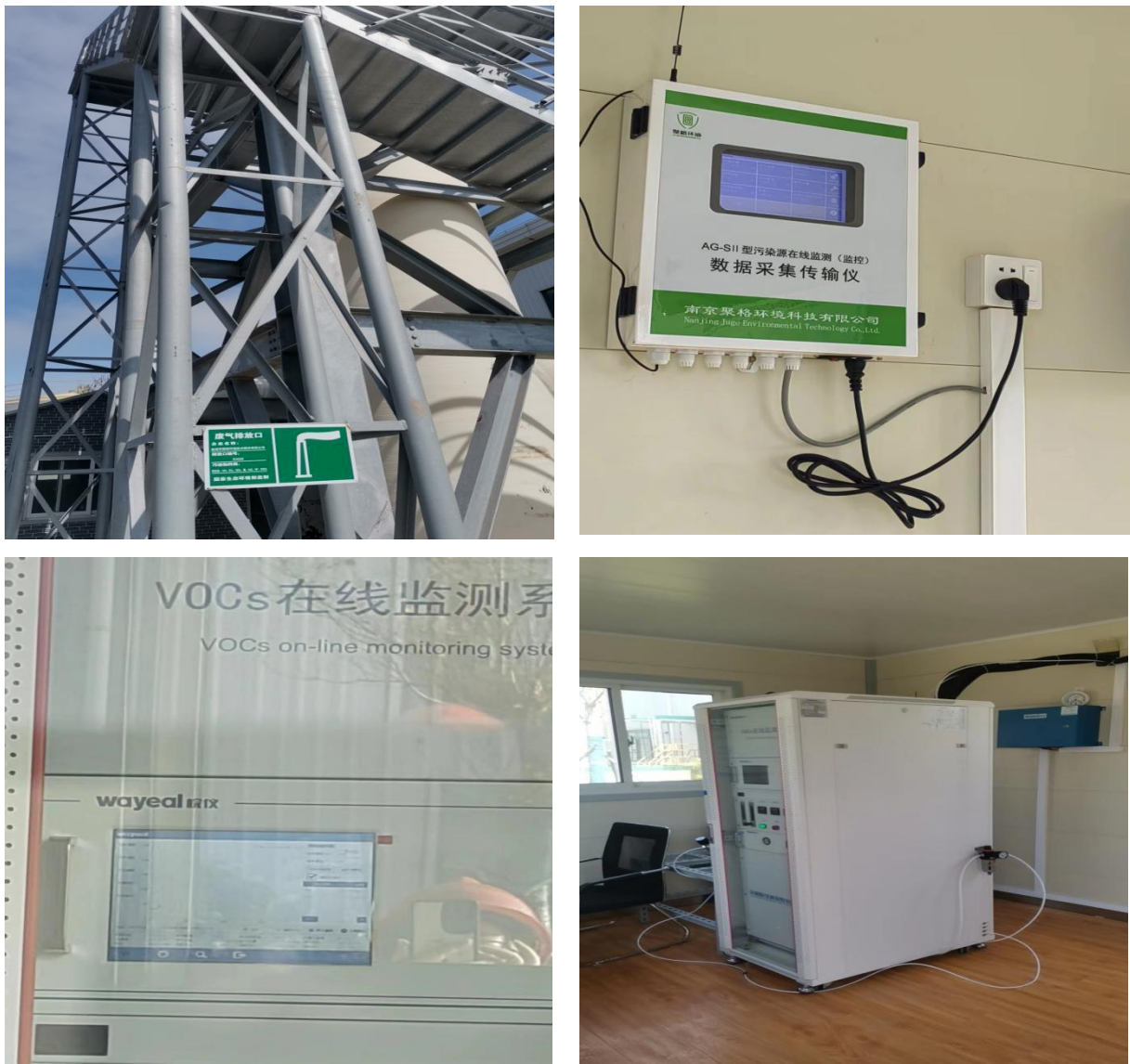
图 4.2-2 2#排气筒采样口及环保标识牌和监测系统
